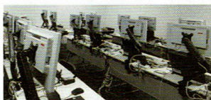
通信受付室 市民からの第一報を受け付けます
